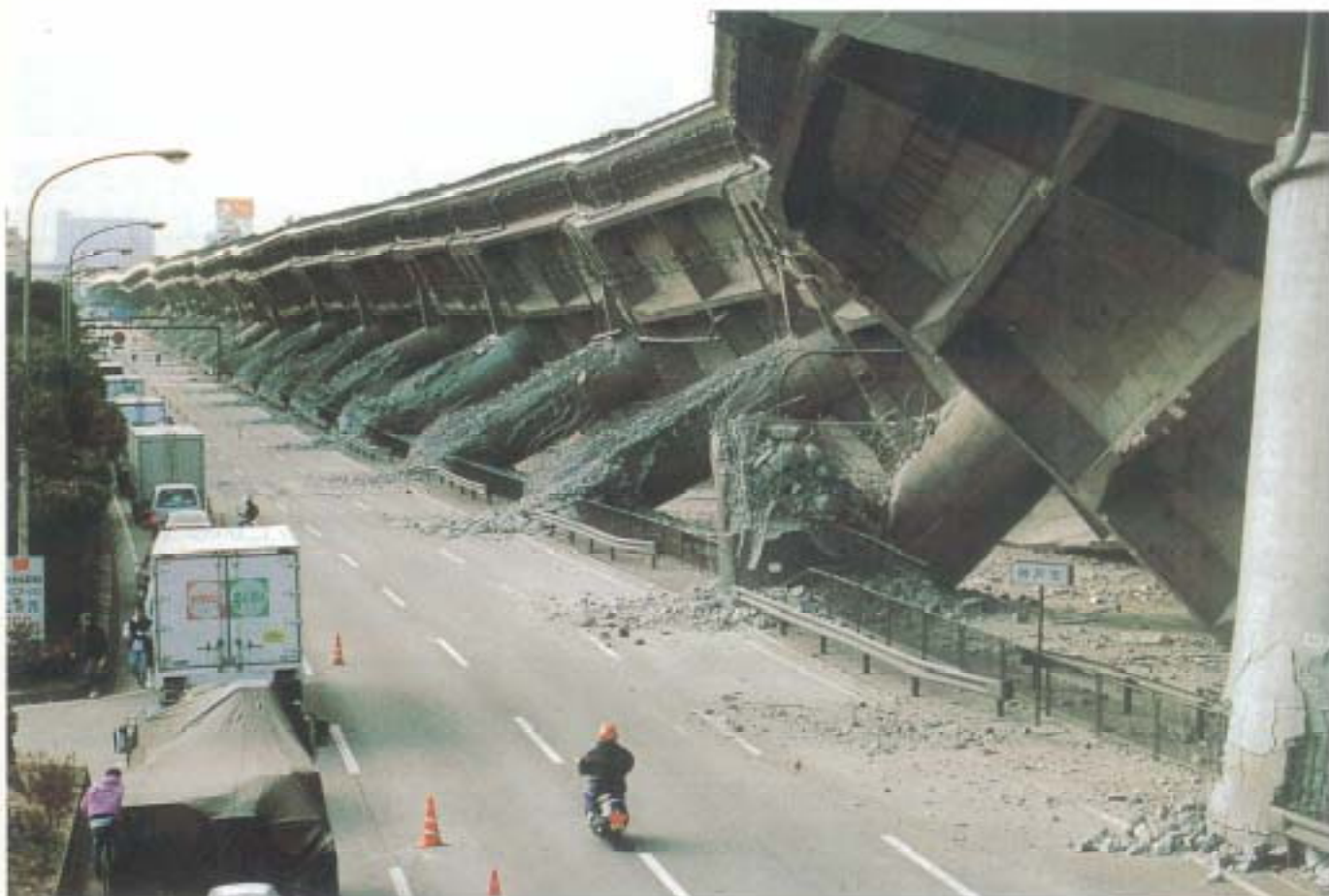
倒壊した阪神高速道路神戸線（平成7年兵庫県南部地震） （中日新聞提供）
